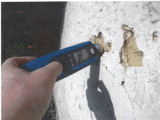
Feuchtigkeitsschaden Außenseite südlicher Dachgeschoss-Giebel (DG / Vorderhaus)
