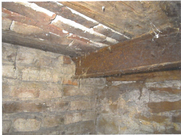
korrodiertes Eisenträger (KG / Vorderhaus)
