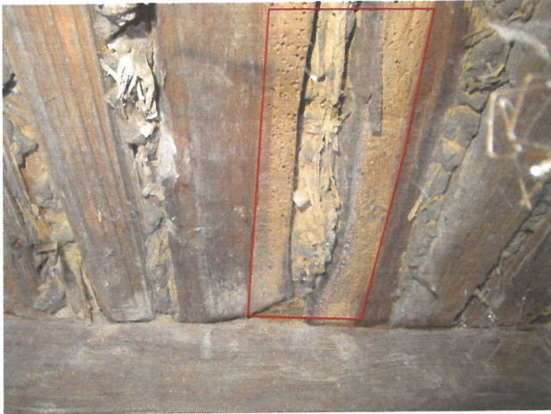
Holzschädlinge KG-Decke (KG / Vorderhaus)
