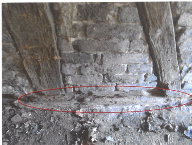
verfallter Schwellbalken (EG / Scheune)
