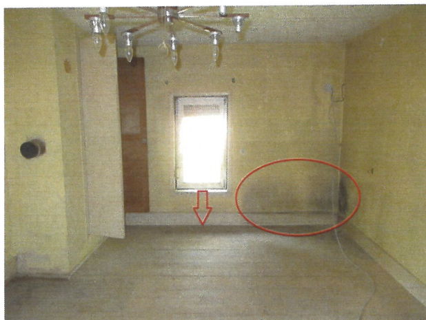
Wohnraumbeispiel mit Feuchtigkeitsschaden und zu niedriger Brüstungshöhe (OG-1 / Vorderhaus)
