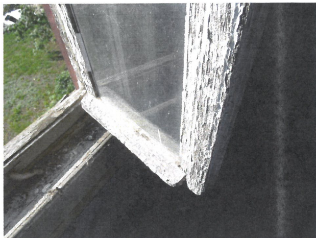
stark bewitterte Fensterflügel (DG / Vorderhaus)
