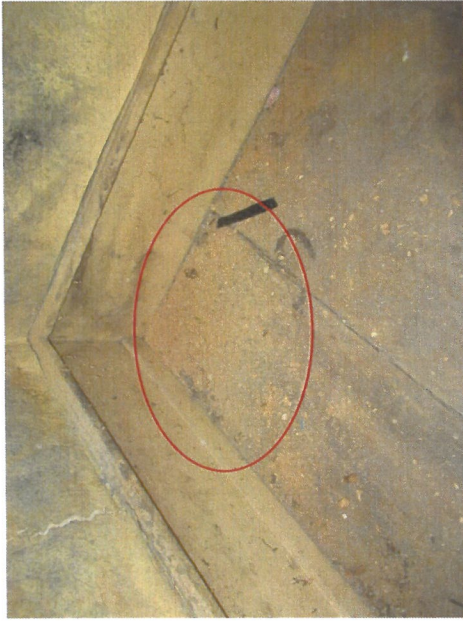
Holzmehl Schädlingsbefall (OG-1 / Vorderhaus)
