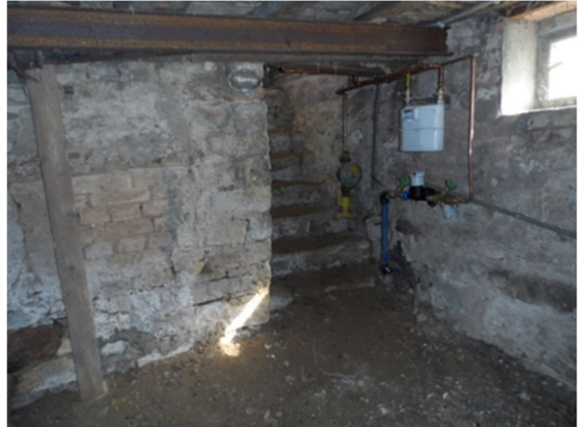
Kellerraum mit Stiege und Medienanschlüssen.
