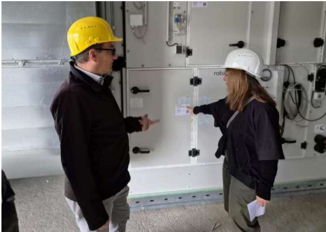
In der Technikzentrale sind die Lüftungsanlagen bereits montiert. Projektleiterin Corina Kaiser bei einem Rundgang durchs Gebäude mit Bürgermeister Dr. Frank Blasch. Foto: Stadt Bad Soden am Taunus
