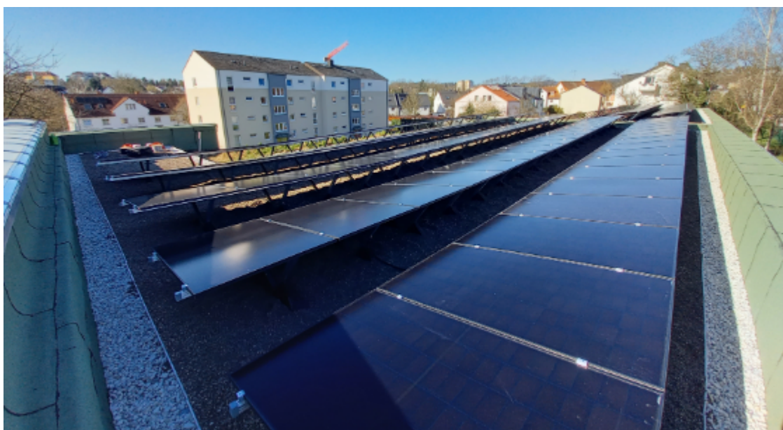
Photovoltaik auf dem Dach des Wasserwerks in der Sulzbacher Straße. Foto: Stadt Bad Soden am Taunus
