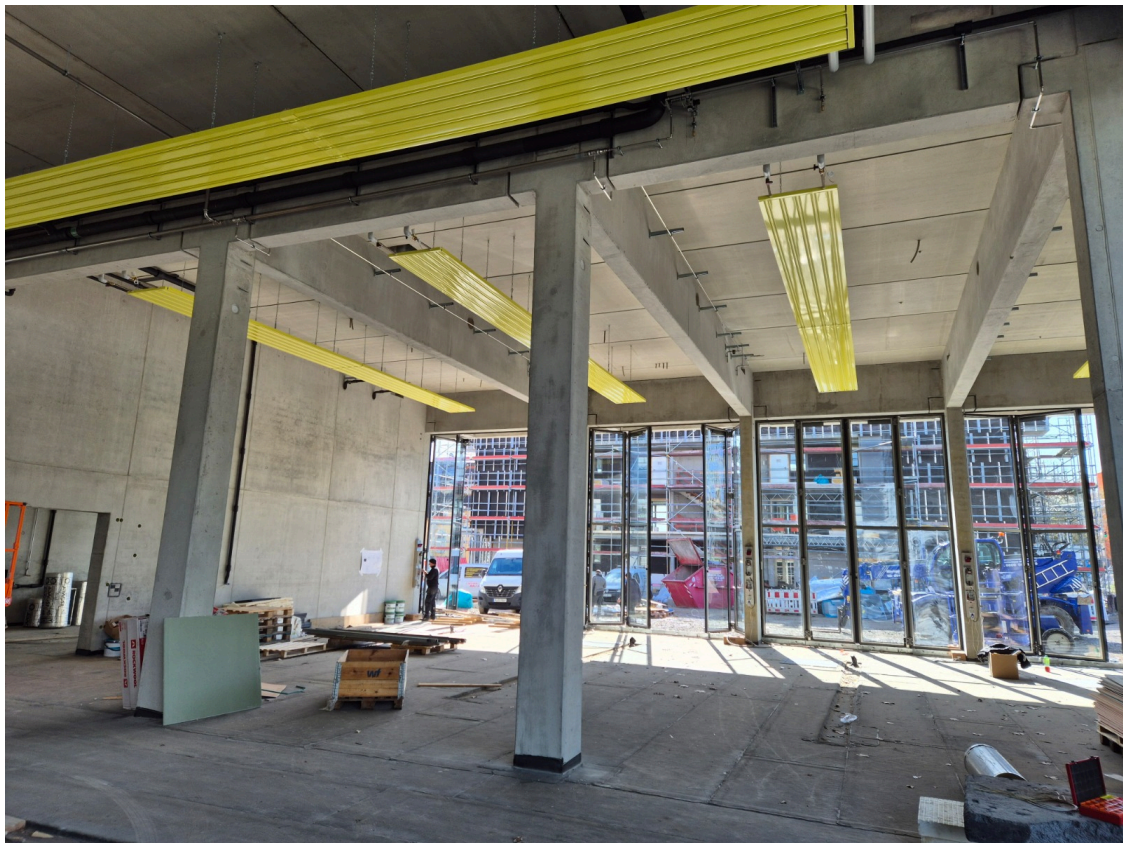
Gelbe Farbtupfer: In der Fahrzeughalle sorgen die Deckenstrahlplatten für Wärme. Foto: Stadt Bad Soden am Taunus
