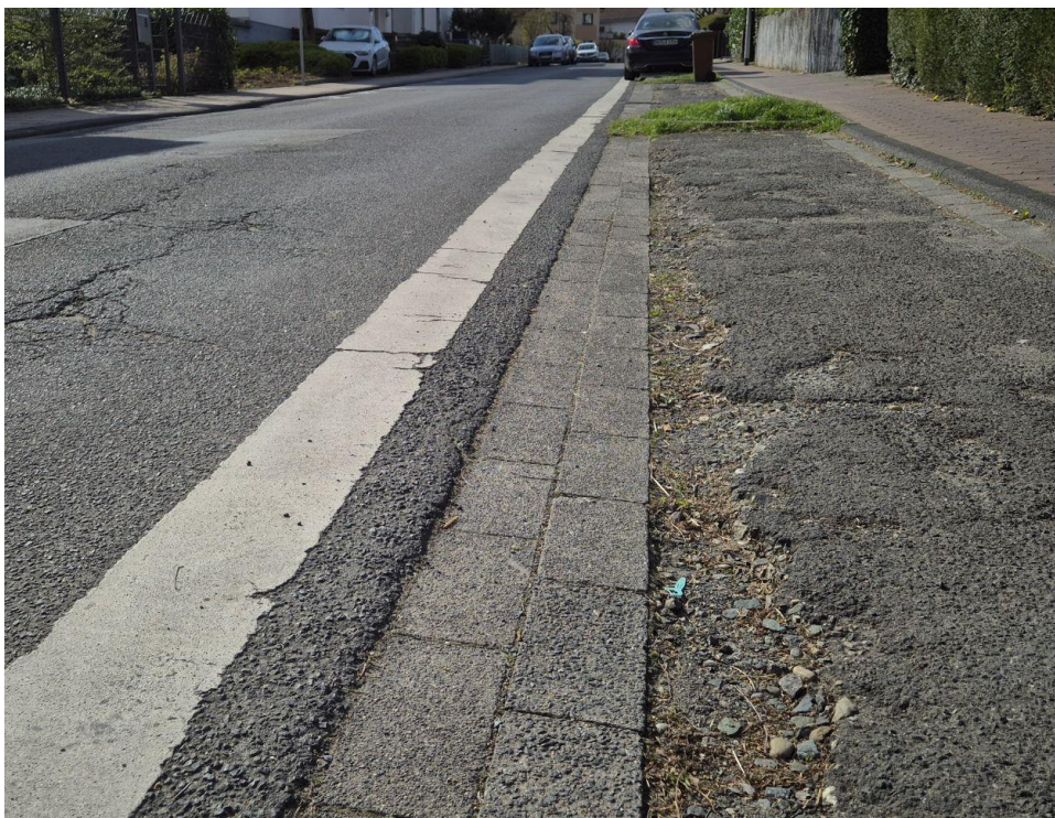
Fahrbahn und Kanäle in der Kronthaler Straße müssen dringend saniert werden. Foto: Stadt Bad Soden am Taunus. Dieses Bild steht HIER zum Download bereit.
